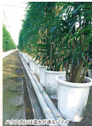
ハウス内には温水が通るパイプ
